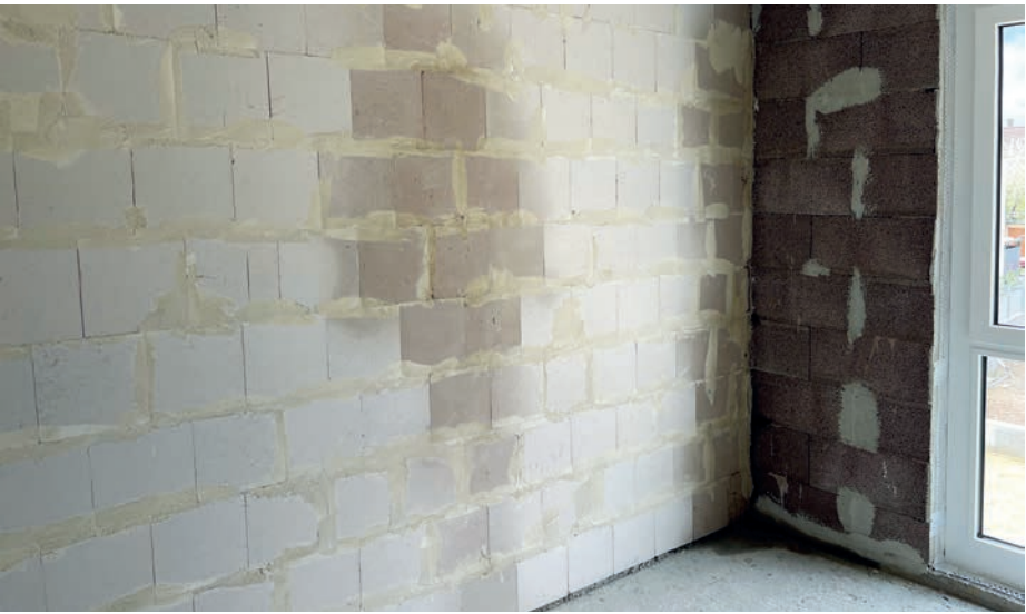
Durchfeuchtete Wand (Fotos: Bauherren-Schutzbund e.V.)
